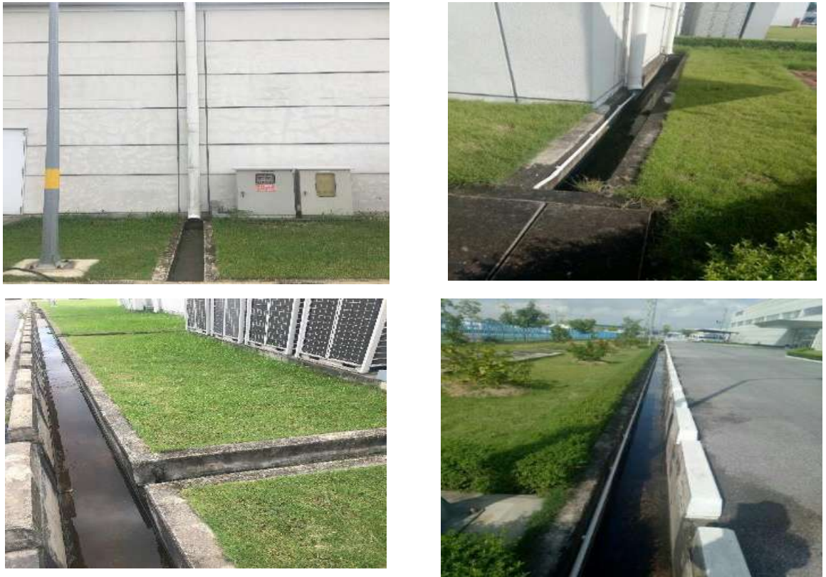
Hình 3.2. Hệ thống thu gom, thoát nước mưa lô 87a
