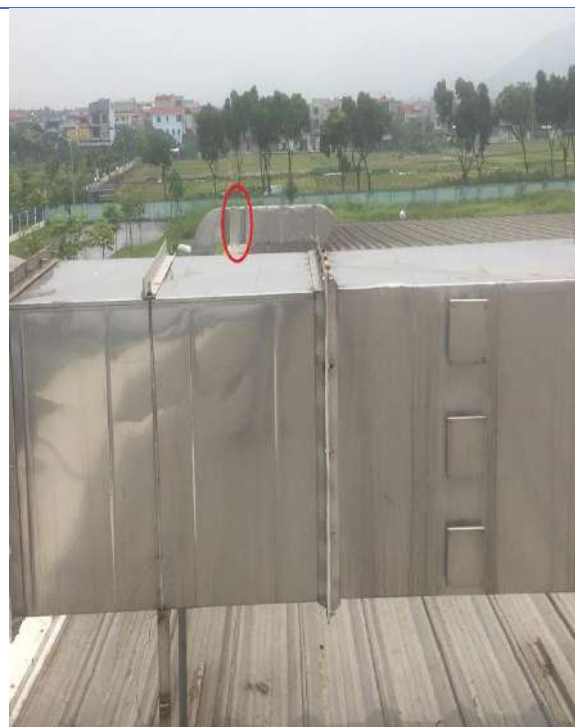
Vị trí lắp đặt tấm lọc than hoạt xử lý bụi và khí thải dây chuyền sản xuất và hàn bảng mạch (DIP)
