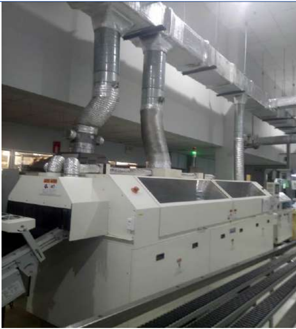
Hệ thống chụp hút và đường dẫn khí thải dây chuyền sản xuất và hàn bảng mạch bằng máy (DIP)
