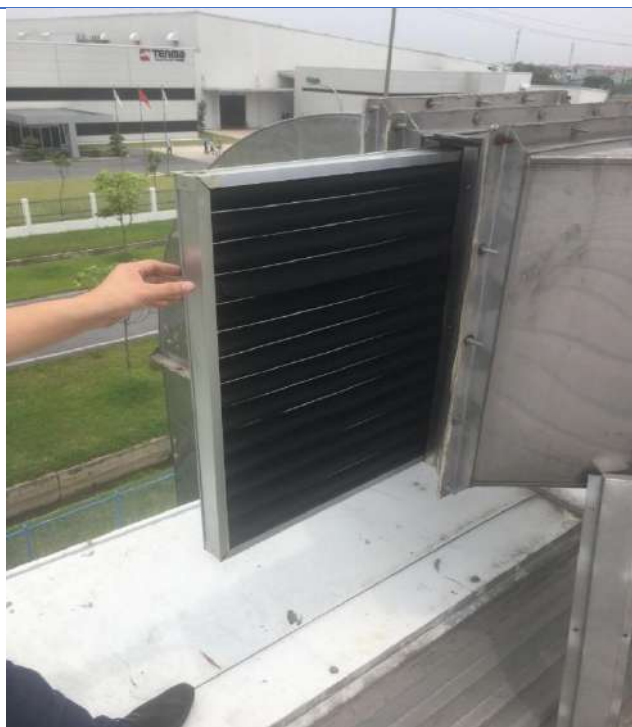
Vị trí lắp đặt tấm lọc than hoạt xử lý bụi và khí thải Dây chuyền sản xuất và hàn bảng mạch (SMT); Máy tái chế xỉ hàn; Xưởng lắp ráp đồ điện, điện tử và các thiết bị gia dụng khác
