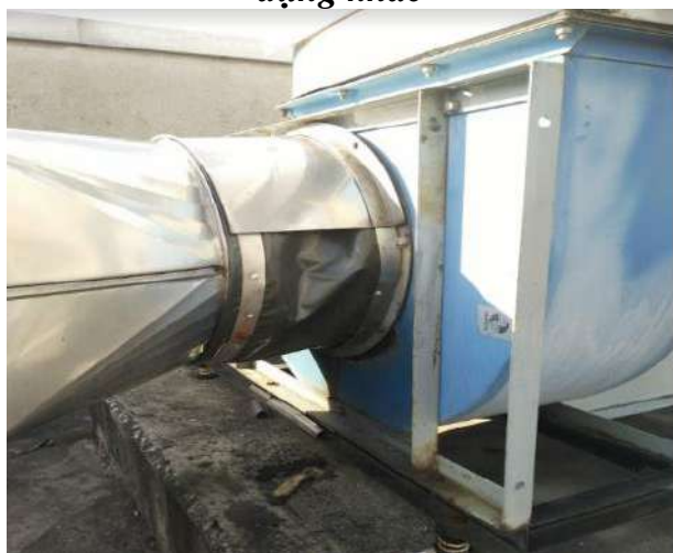
Màng lọc khí thải (vật liệu nồi ống hút và quạt) nhà bếp
