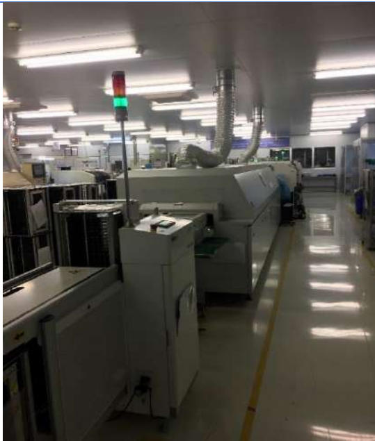
Hệ thống chụp hút và đường dẫn khí thải dây chuyền sản xuất và hàn băng mạch (SMT)
