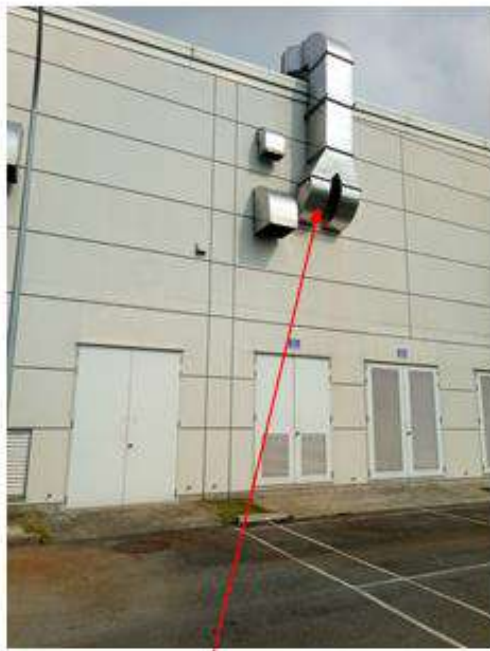
Ống khói khí thải Dây chuyền sản xuất và hàn bảng mạch (SMT); Máy tái chế xỉ hàn; Xưởng lắp ráp đồ điện, điện tử và các thiết bị gia dụng khác
