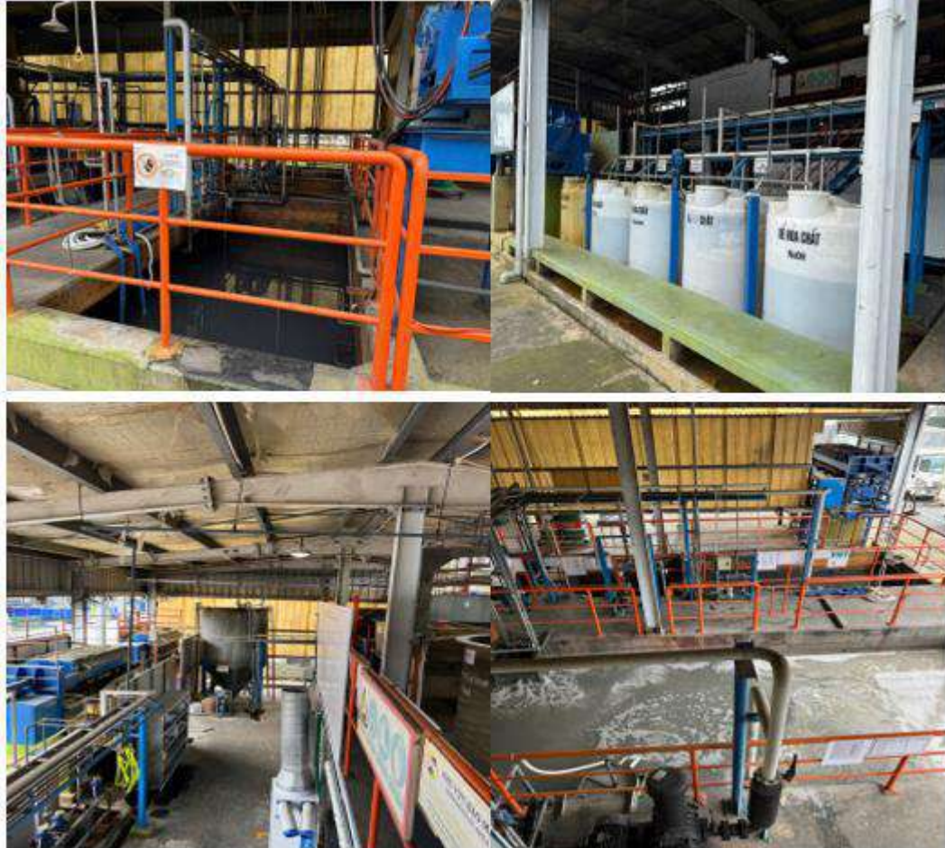
Hình 3.5. Hình ảnh thực tế hệ thống xử lý nước thải tại cơ sở
