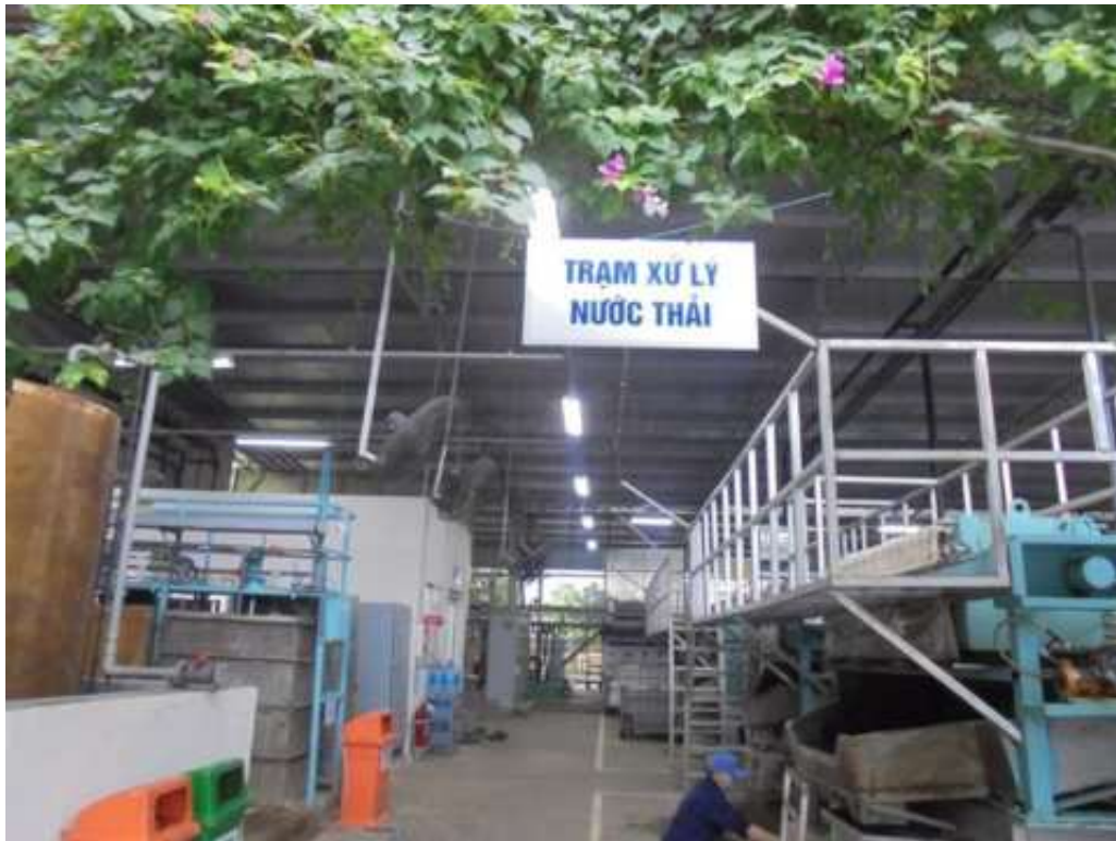
Hình 3.4 Trạm xử lý nước thải của cơ sở
