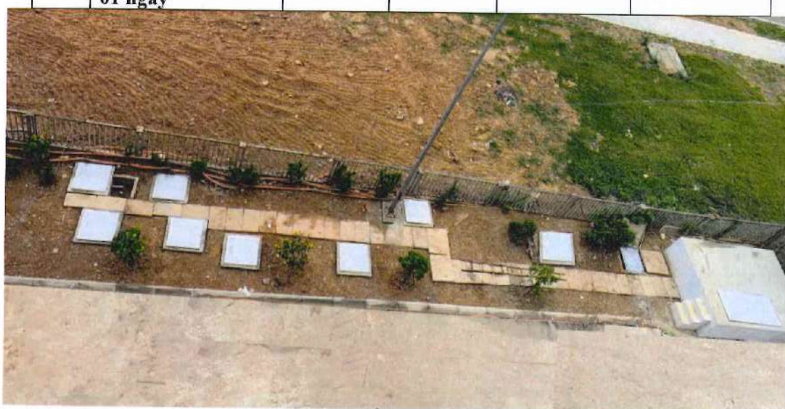
Hình 7 Hệ thống xử lý nước thải sinh hoạt công suất 100 m 3 /ngày đêm
