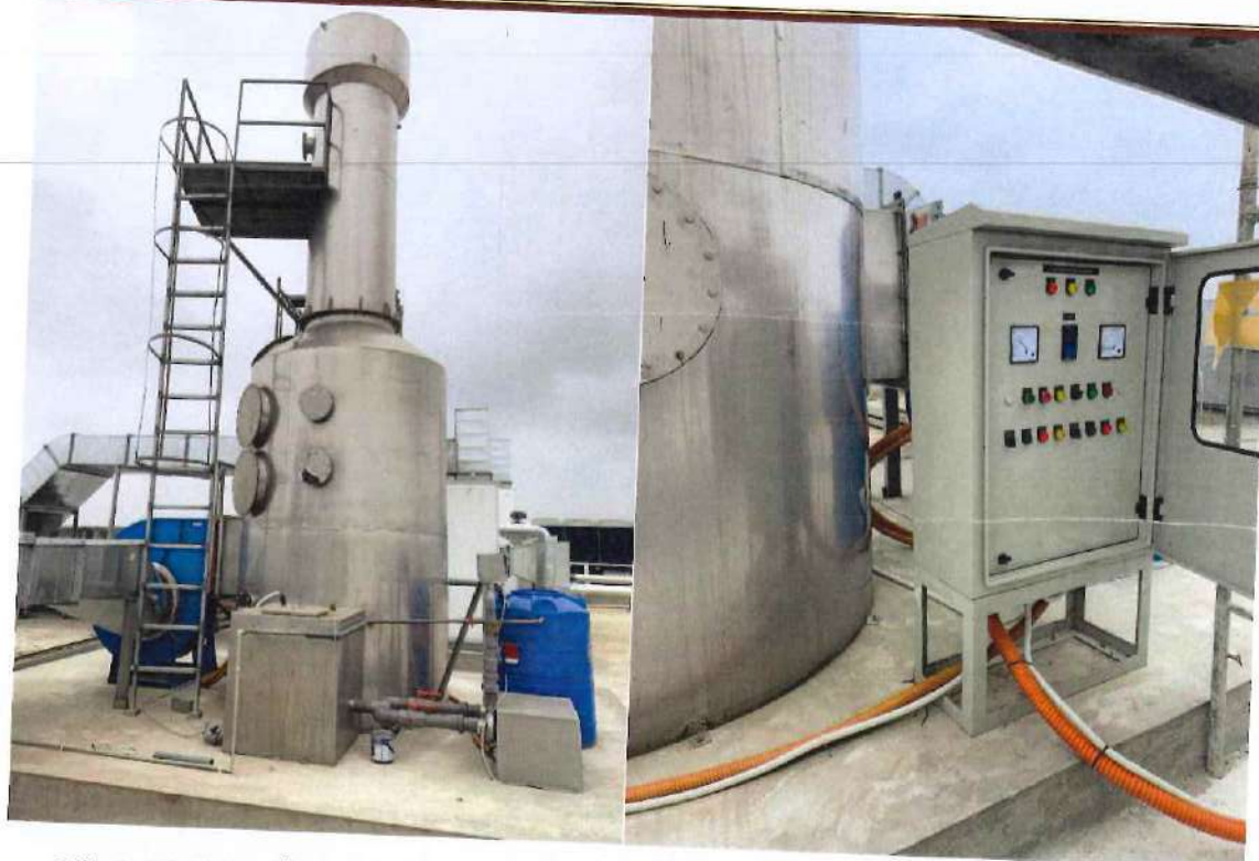
Hình 11 Hệ thống thu gom và xử lý khí thải của khối nhà máy sản xuất số 2
