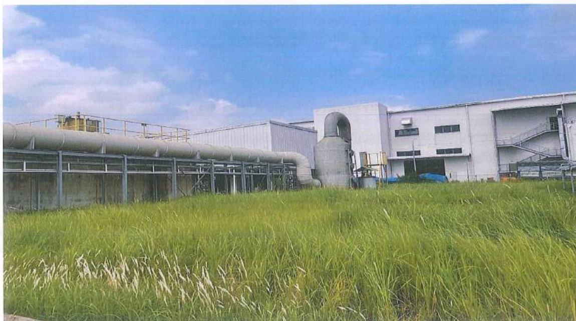
Hình 10: Hệ thống xử lý khí thải của nhà máy
