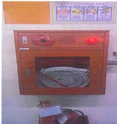
Hình 12: Trang thiết bị PCCC tại Nhà máy
