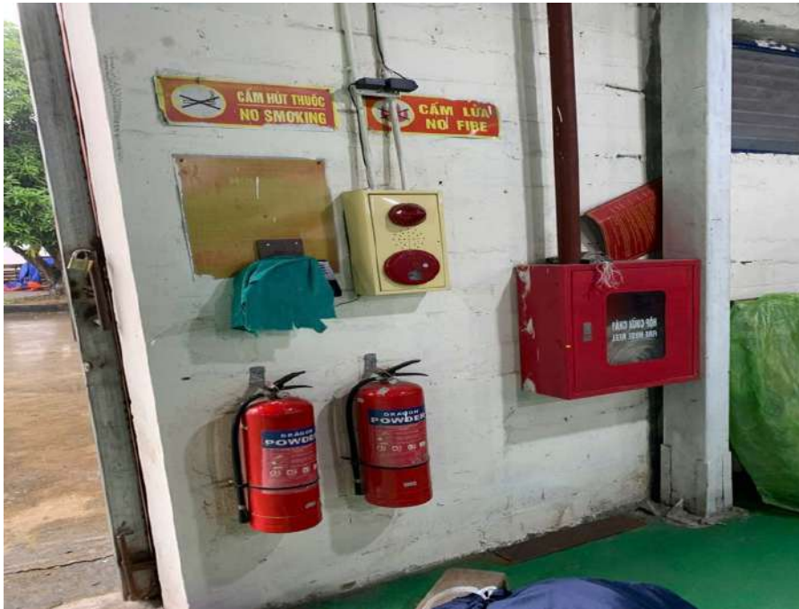
Hình12. Thiết bị phòng cháy chữa cháy của Dự án
