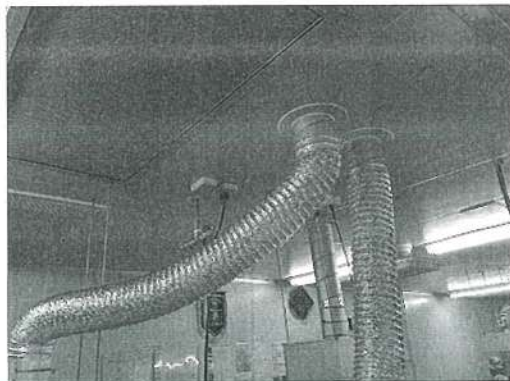
Hình 15. Hệ thống chụp hút và đường dẫn khí dây chuyền sơn
