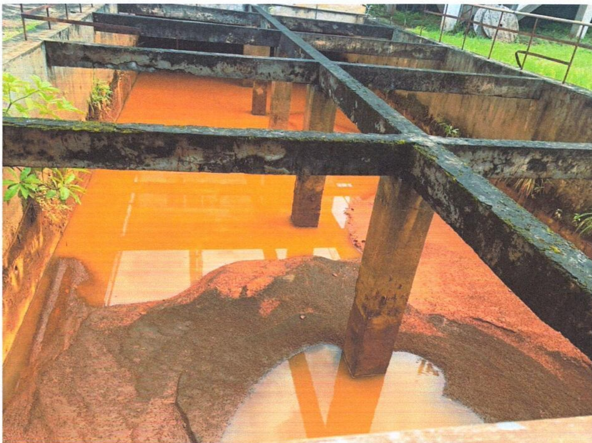
Hình ảnh khu vực chứa bùn sau xử lý rửa hệ thống lọc (trách nhiệm của Công ty Cổ phần Hanel)
