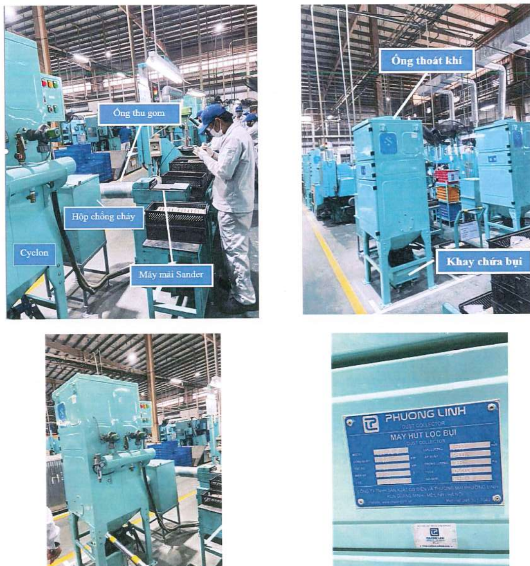
Hình 18: Hình ảnh hệ thống thu gom, xử lý bụi, khí thải máy mài Sander tại Nhà máy
