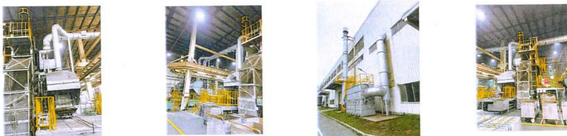
Hình 21: Một số hình ảnh hệ thống xử lý khí thải hệ thống lò nấu chảy trung tâm
