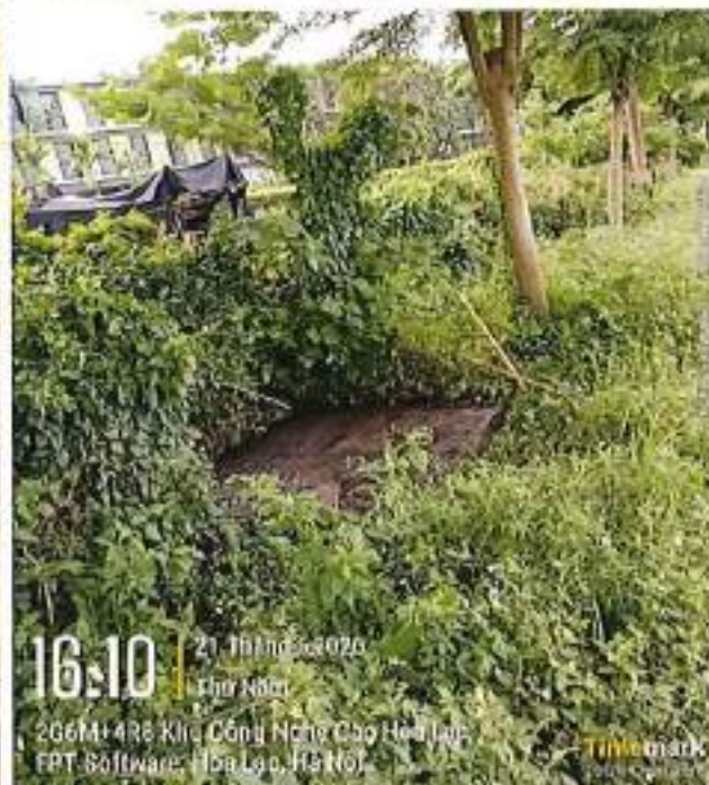
Hố ga đầu nổi nước mưa khu FVI
